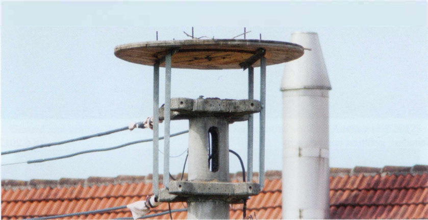
Plattform der Lechwerke auf isoliertem Strommasten
